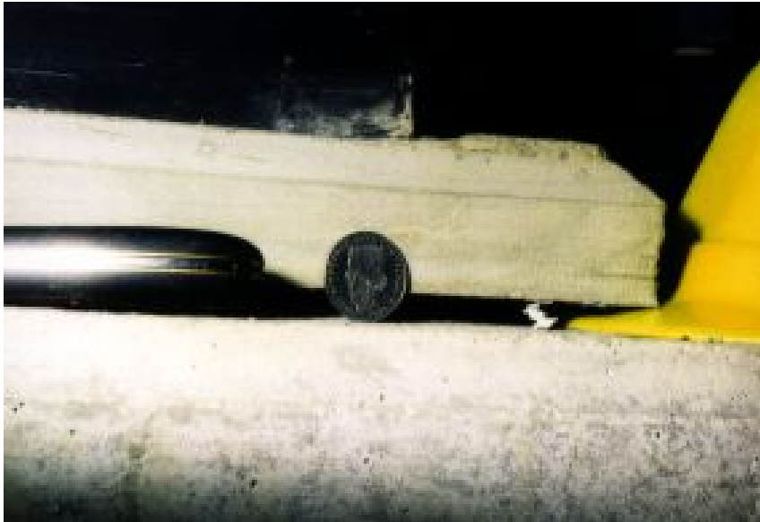
Bild 1-1 Lagerabhebung an einer Kanalbrücke
