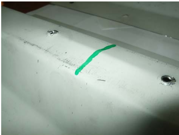
Bild 5 Deformation des Blechs (mittiger Anschluss)
