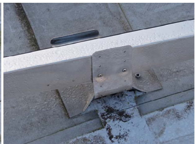
Bild 7 lokale Ablösung der Klebelasche durch Schalen
