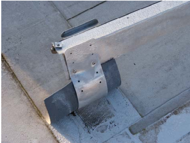
Bild 8 großflächige Ablösung der Klebe-Lasche
